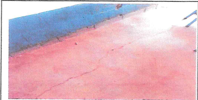
Foto 3: Piso de concreto dereriorado en las aulas
